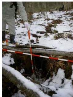
⑤開口した亀裂
