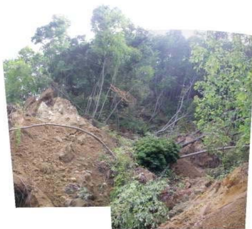
Bブロック頭部滑落崖状況
