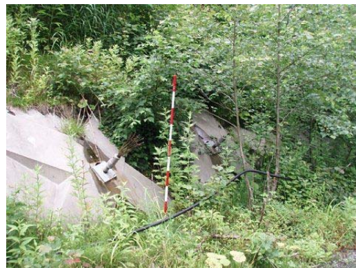
アンカー頭部破断状況
