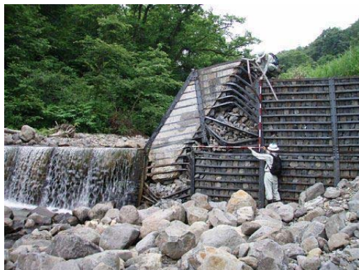
鋼製堰堤変形状況
