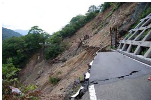
⑥ホ-42 国道342が崩落した崩壊
