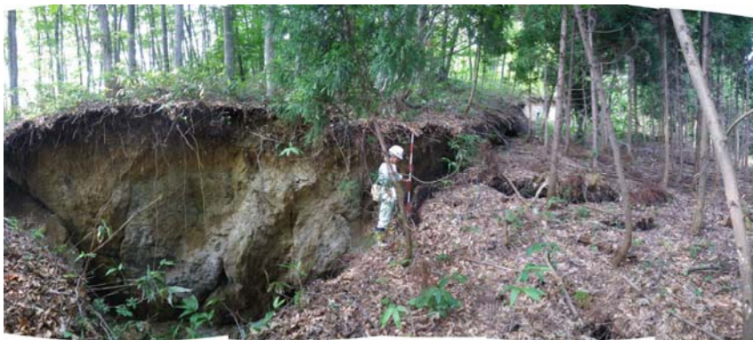
地すべりの冠頭部滑落崖 段差3～4m
