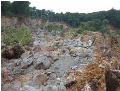
②崩壊状況と崩壊地内の溶結凝灰岩の岩塊
