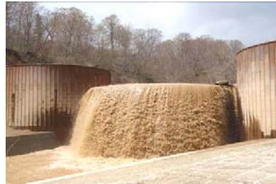
土石流を捕捉した治山ダム (岩手県一関市(産女川))
