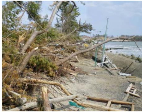
倒壊した防潮護岸工(宮城県気仙沼市)
