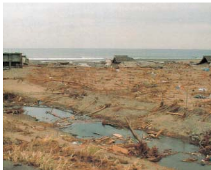
破壊された防潮堤と海岸林（田野畑村明戸）
