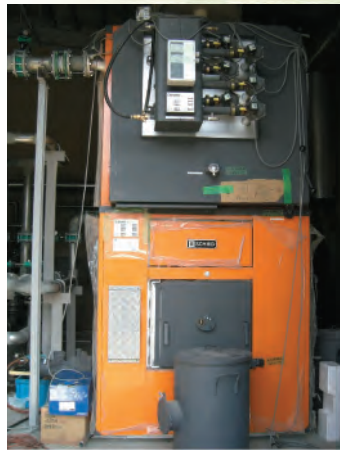
導入した木質チップボイラー
