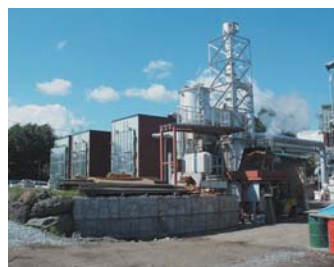
ポイラーと増設した乾燥機
