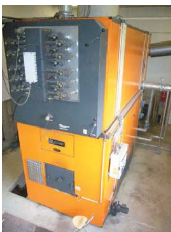
スイス製のチップボイラー
