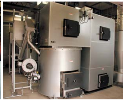
静和園で稼働しているペレットボイラー
