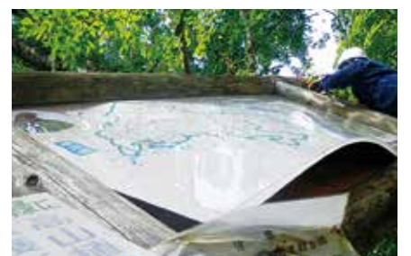
積雪により歪んだ看板
