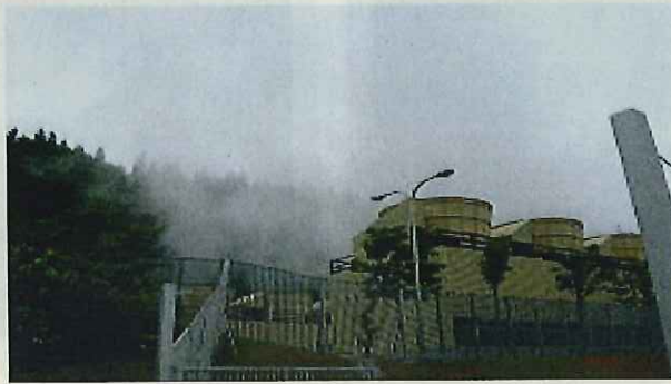
現在稼働している「上の岱発電所」タービン
