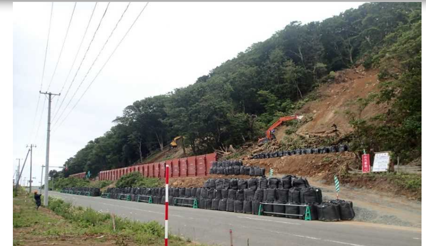
令和3年豪雨災害の復旧工事施工状況 (風間浦村下風呂地区)
