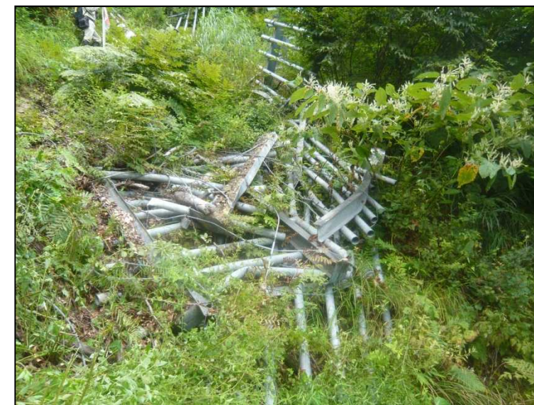
既設なだれ防止柵の破損状況
