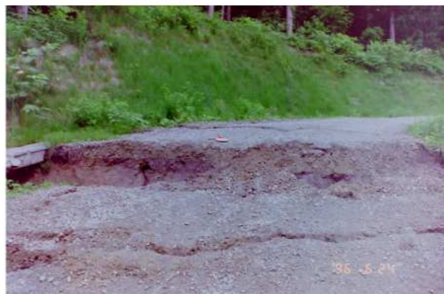
写真 ⑦ I 拡大ブロック仮設道に発生した亀裂
