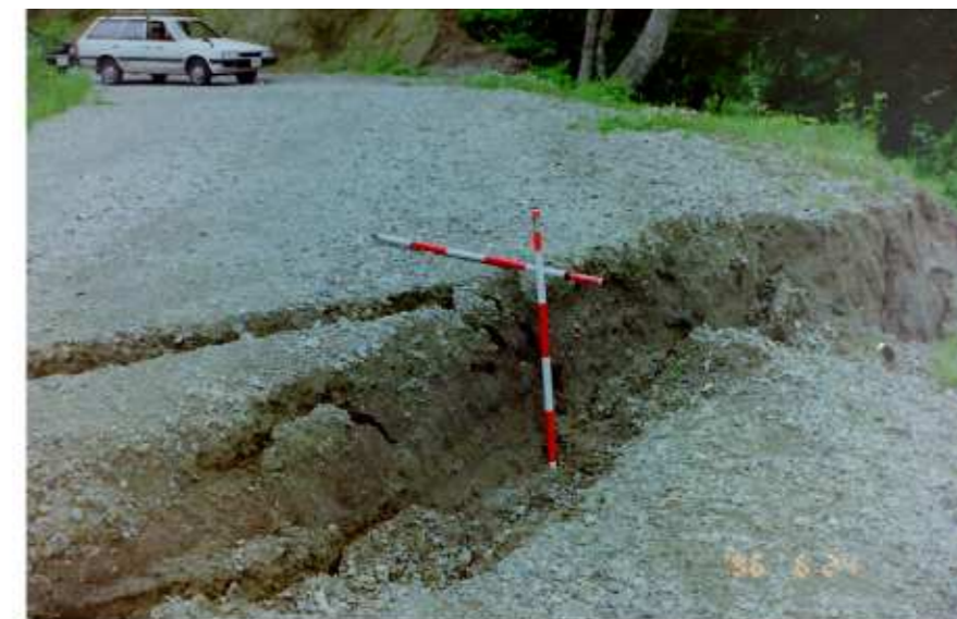
写真 ⑧ I 拡大ブロック拡大ブロックに発生した亀裂
