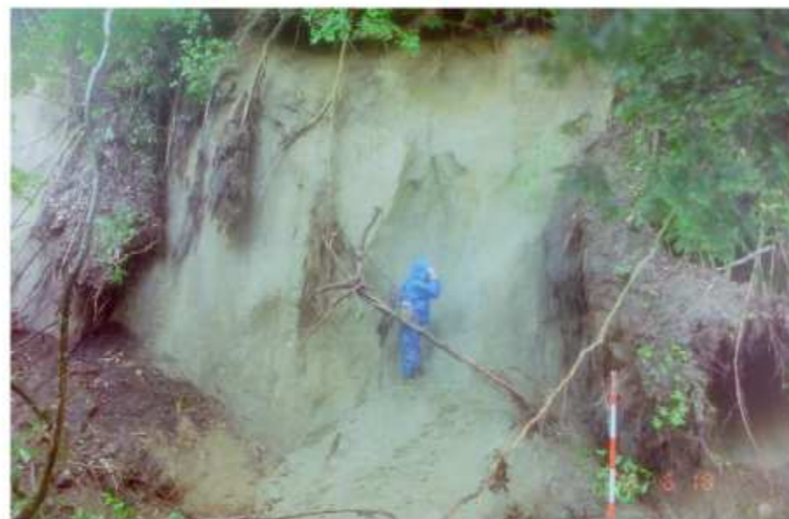
写真 ⑭ 滑落部帯上流壁
