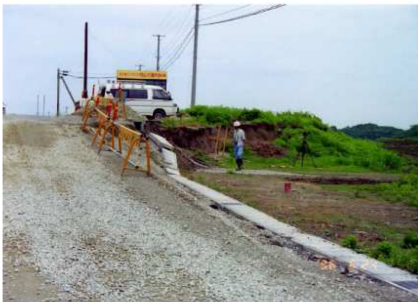
写真 ⑳ 陥没帯の下流壁（写真左手が斜面下方）
