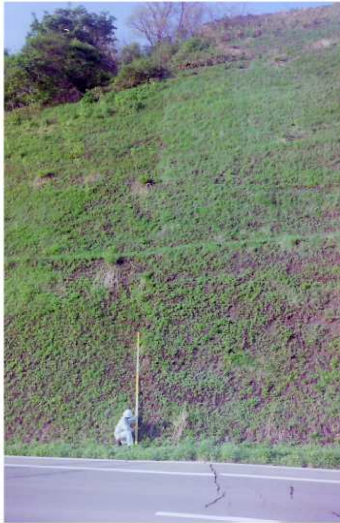
写真 ⑪ ブロック右側壁中腹部の国道 458 号の法面に発生した亀裂
