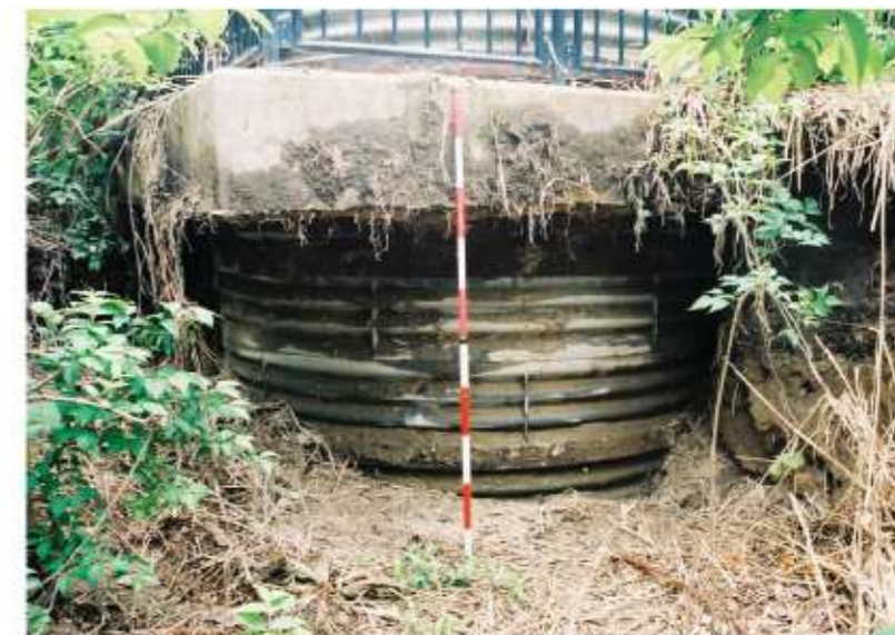
写真 ⑨ 56 災ブロック集水井の抜けだし
