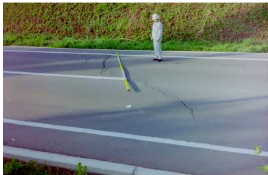
写真 ⑫ ブロック右側壁中腹部の国道 458 号の法面に発生した亀裂
