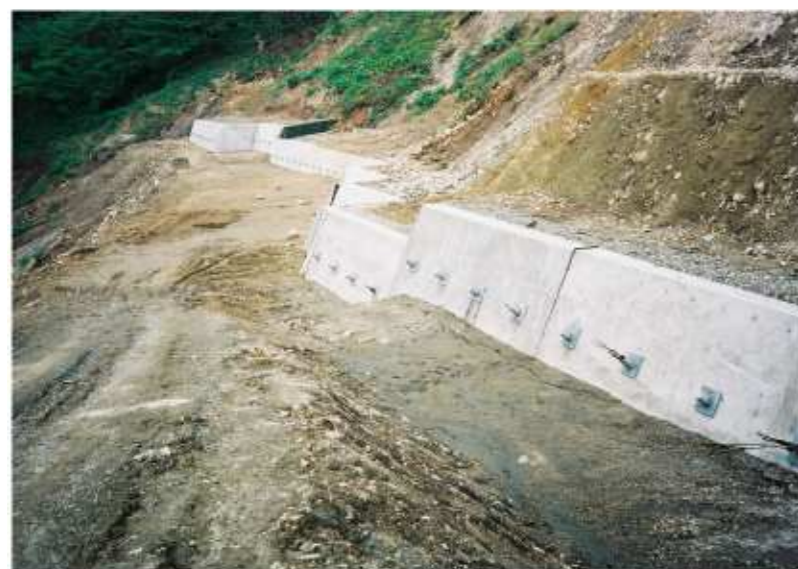
写真 ④ 地すべり末端部で破壊されたアンカー受圧版
