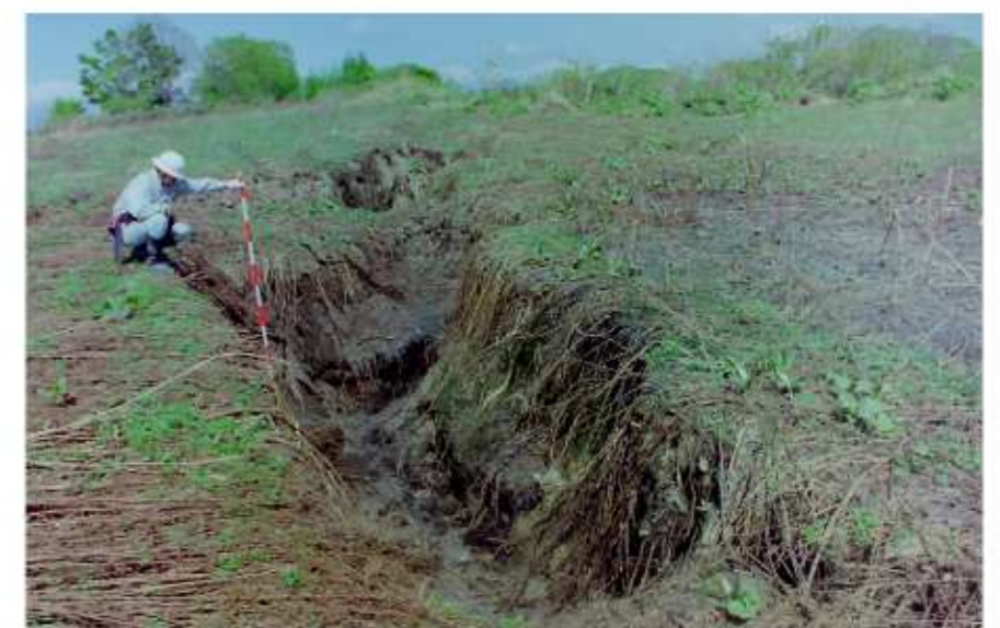
写真 ⑰ 陥没帯に発生した開口亀裂
