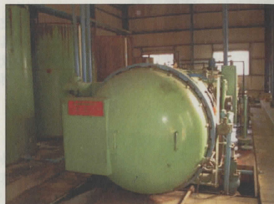
加圧式防腐処理プラント（日産10m 3 ） 2回転
