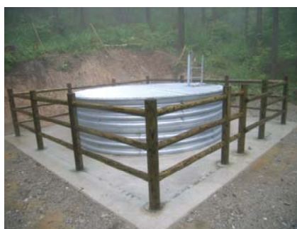
集水井工の木柵工 (高知県大川村)
