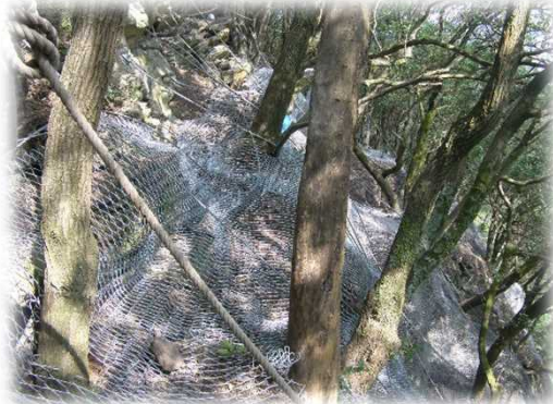
下方にある観光道路への落石を防止 (屋島国有林)
