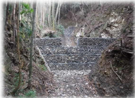
荒廃した溪流に設置された堰堤 （まんのう町 滝山国有林）
