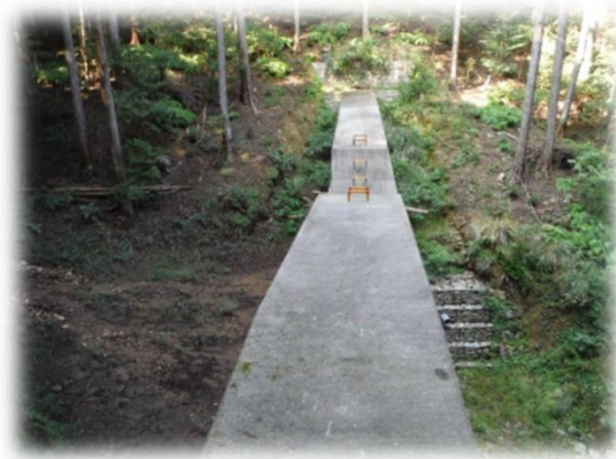
緩和された溪床勾配（堰堤の上流側（写真左側）に土砂を堆積させ谷の勾配を緩和）
