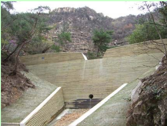
写真 コンクリート谷止工の壁面に使用した木製の残置式型枠（治山事業）
