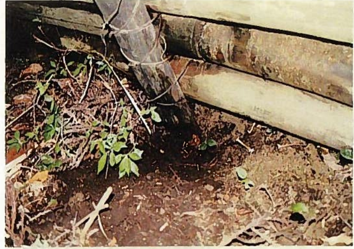
地際 (腐蝕がひどい) 岡本林道
