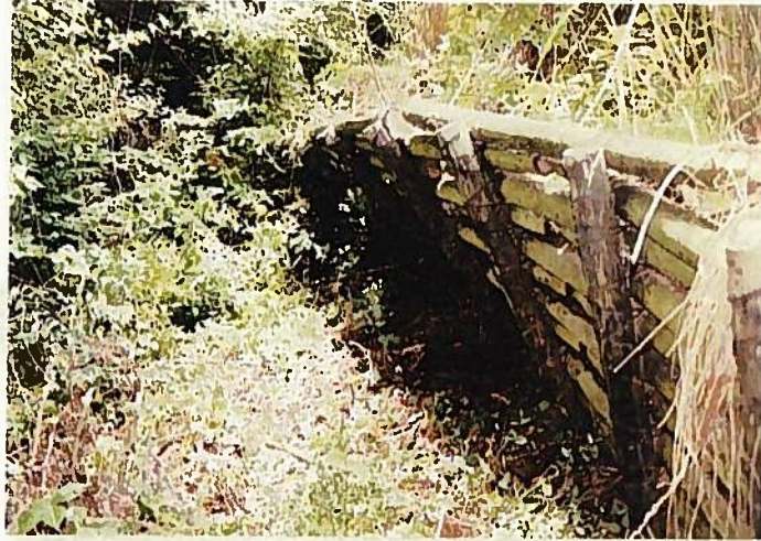
(工程) 木柵工(c) 近景 (土圧に倒れている)
