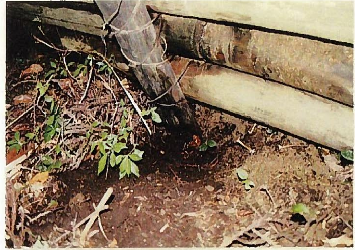
地際 (腐蝕がはじか) 岡本林道
