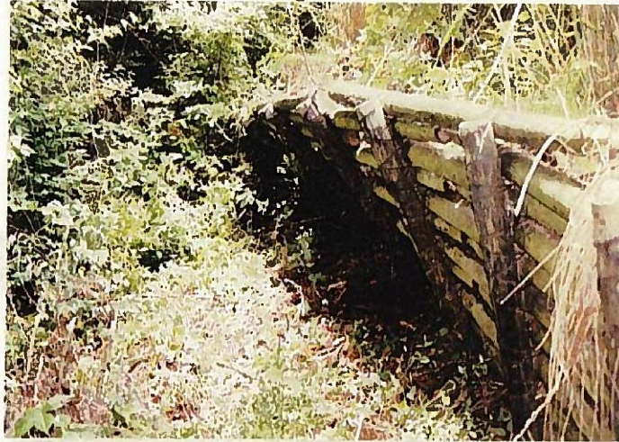
(工種) 木柵工(C) 近景 (土圧に倒れている)
