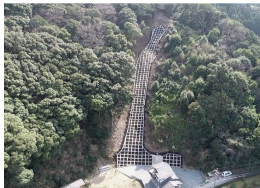
大雨による林地崩壊箇所において、山腹工を実施し、森林の復旧により拡大崩壊を防ぎます。(大江灘国有林 163林班)
