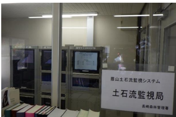
・眉山治山事業所に設置された監視システム
