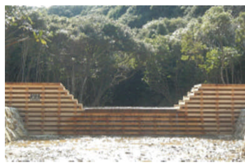
木材を利用した治山ダム
