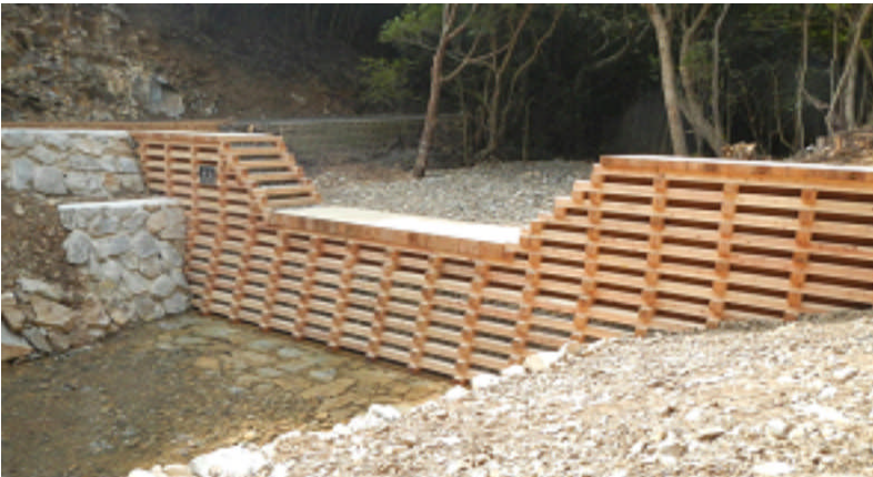
木材や現地で発生した土石を活用した治山施設＝木製床固工（長崎県五島市）
