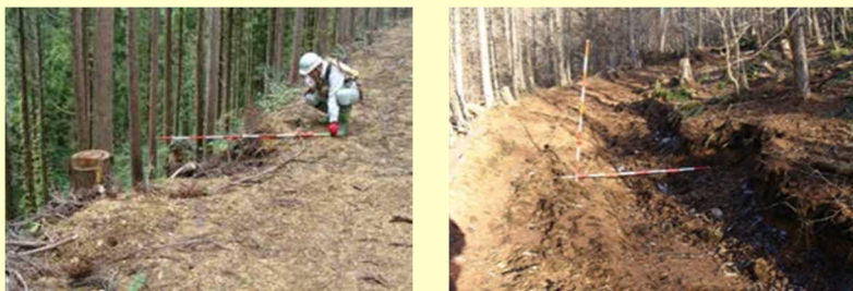
損壊状況等の調査（左：路肩崩壊箇所、右：路面洗掘箇所）
