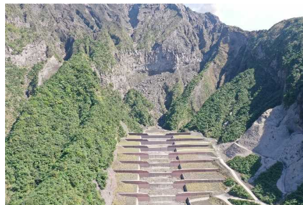
土石流を抑制する溪間工(桜島)
