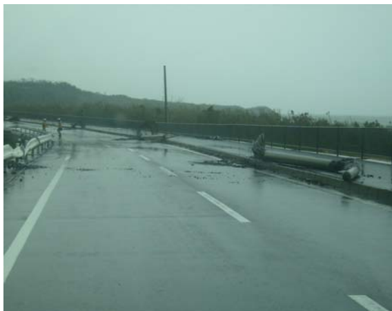
台風による被害（電柱の倒壊現場）
