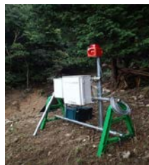
【土石流センサー設置状況】
