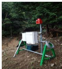
【土石流センサー設置状況】
