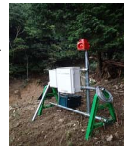
【土石流センサー設置状況】
