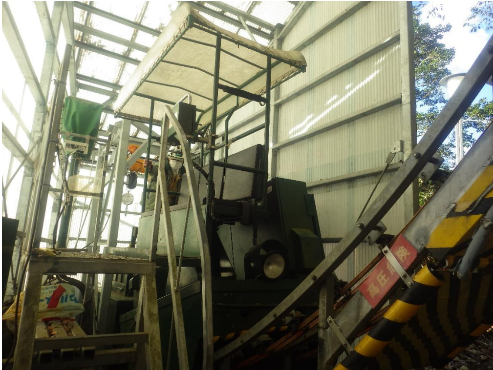
写真 11 銚子川第二発電所のモノレール
