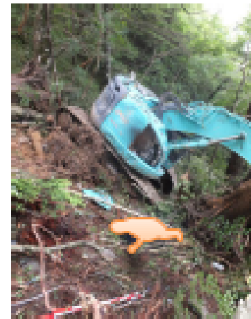
転落後の状況
