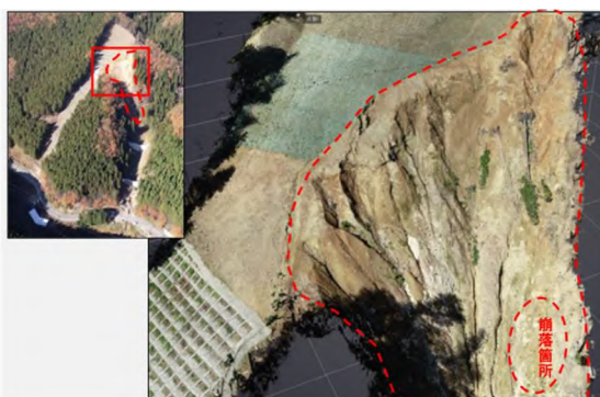
写真－2 東斜面上部の状況
