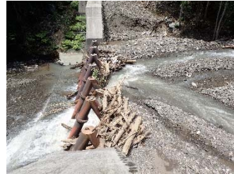
（既設スリットダムの流木等を捕捉した様子）
