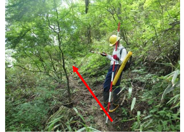
③ モノレール設置場所
