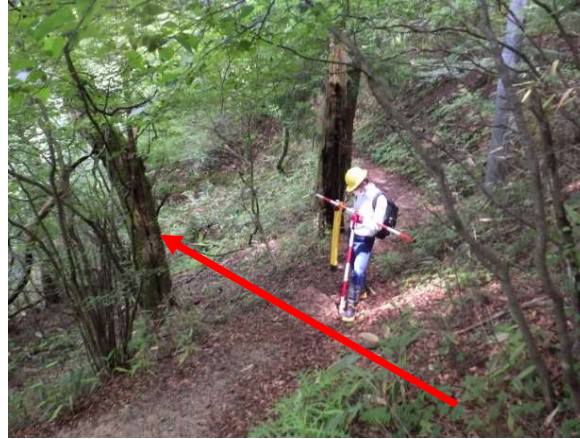
② モノレール設置場所
