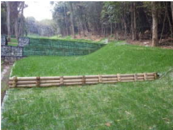
清水坂山腹工事（加古川市清水坂国有林） 丸太筋工（9m 利用）
