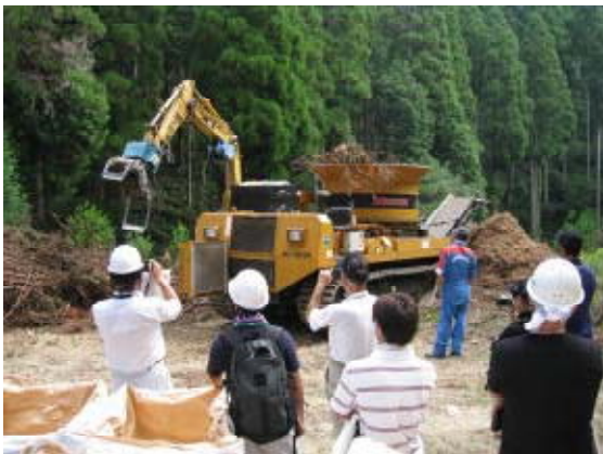
林地残材を集積後、破碎する木材破砕機 （兵庫県主催：宍粟市一宮町民有地）
