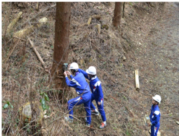
定点カメラの保守作業体験
