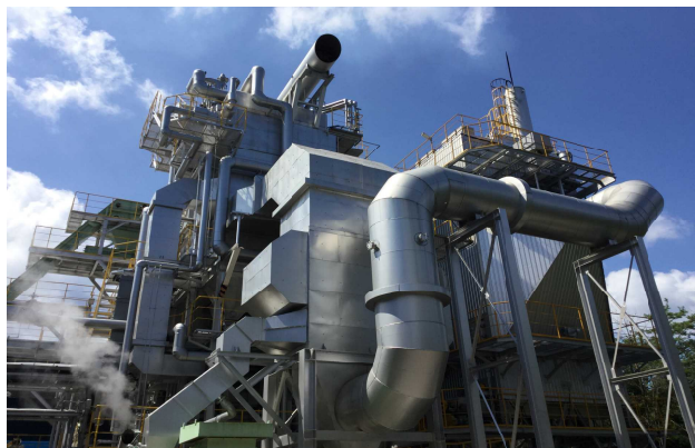
木質バイオマス発電所
