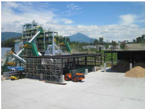
日本初の木材チップ専焼発電所
