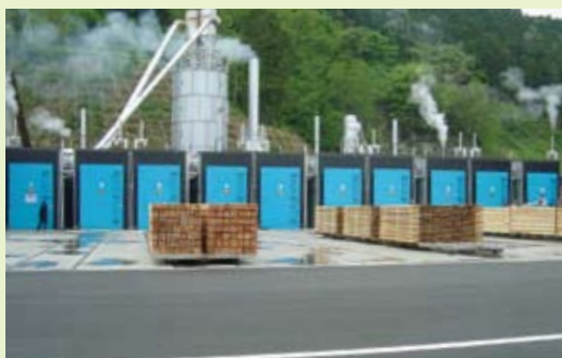
乾燥機 (燃料は端材・樹皮等で全てまかなっている)
