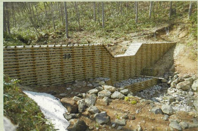
間伐材を利用した治山施設
