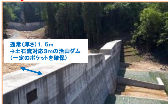
土石流の衝撃に対応できる厚みのある治山ダム
