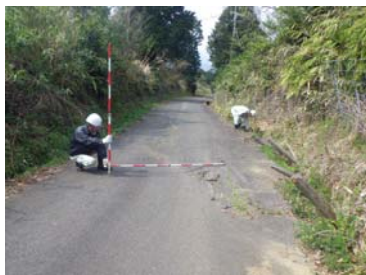
④ 市道の段差状況
