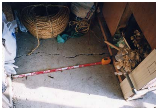
② 被災状況(家屋内に発生したクラック)
