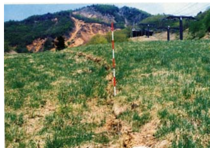
② 地すべりにより発生した亀裂
