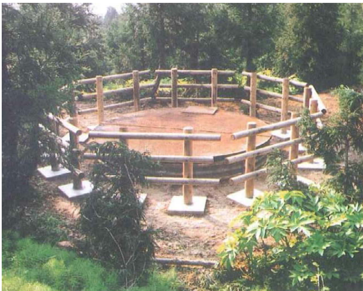
集水井用安全柵工 平成 11 年度施工／スギ間伐材 1.02 m 3 使用
