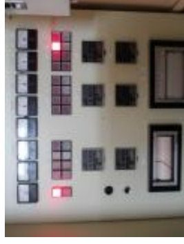
基盤等の破損により 漏電警報ランプのみ作動
