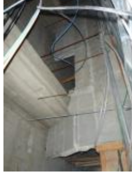
天井内コンクリ壁の倒壊
